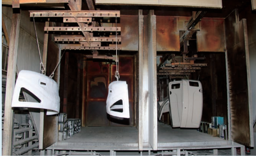
◀ 電着塗装ライン ハイブリッド炉の出入口
